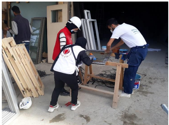
La mobilisation de volontaires venant de tous les corps de métier du bâtiment
