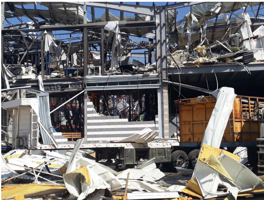
Dégâts dans les entrepôts du port
